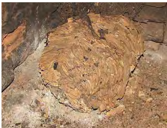
Gniazdo szerszeni strącone z wnętrza komina podczas prac kominarskich
